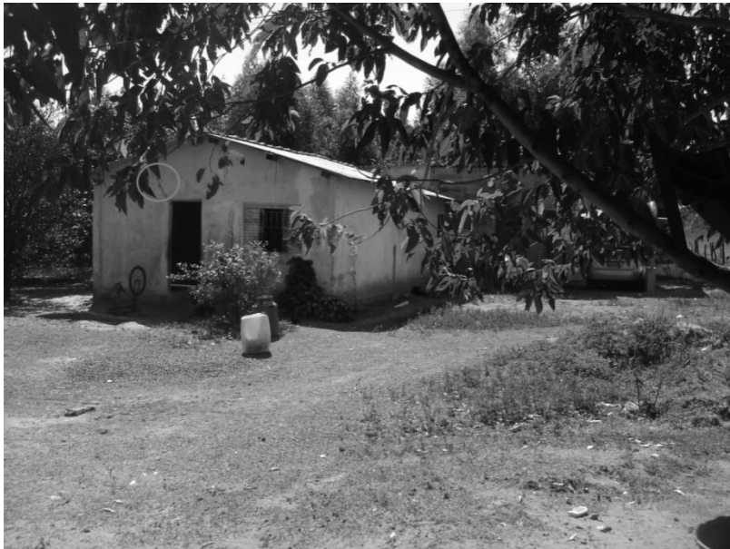
Foto 01: Fissura na moradia do lote
