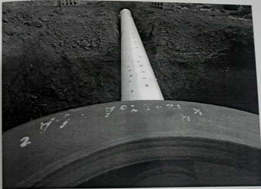
Foto 4 – Tubulação de saída do sistema com os furos feitos para que o efluente do tratamento drene pela camada de brita filtrante. Obs.: Os furos estão para cima apenas por conveniência fotográfica. Os mesmos devem ficar virados em direção ao solo. Fonte: Eng.º Talles Gigliotti Bezerra
