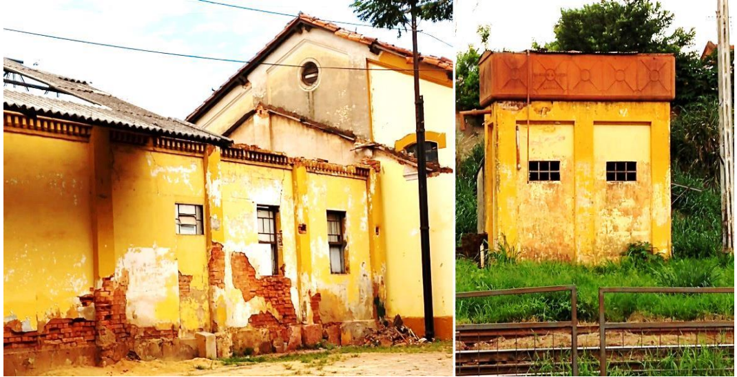
Figura 88 – Prédios anexos ao Museu Ferroviário, deteriorados. À direita, a caixa d'água que abastecia as caldeiras das locomotivas a vapor.
