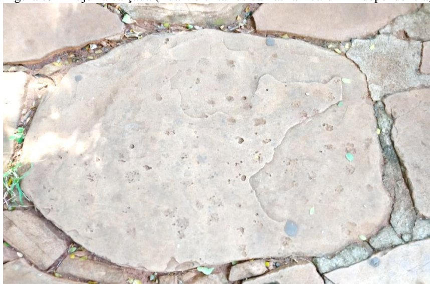
Figura 79 – Laje na calçada (Rua Voluntários da Pátria – Jardim Independência).
