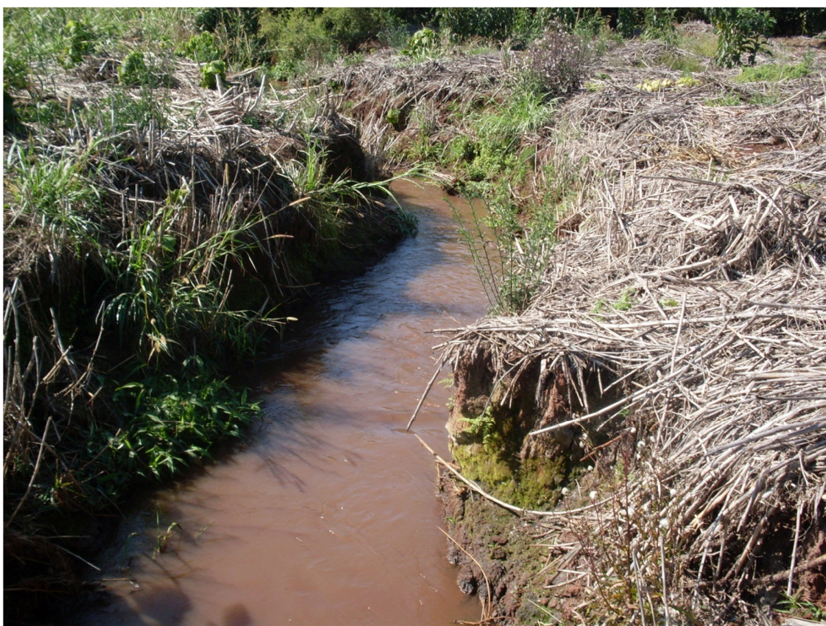
Figura 34 Processo erosivo nas margens do Ribeirão do Cruzeiro. Fonte: próprio autor, 2010.
