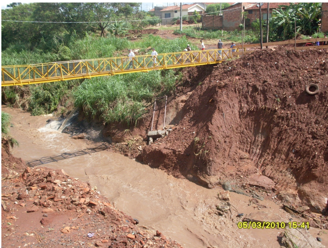
Figura 12 Local onde havia uma travessia (ponte). Ao fundo, passarela improvisada para travessia dos pedestres. Fonte: próprio autor, 2010.
