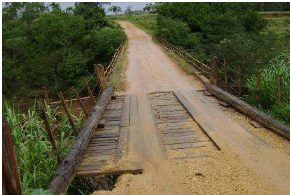
FIGURA 53: Foto da ponte com cabeceira destruída sobre o córrego Água Limpa.
