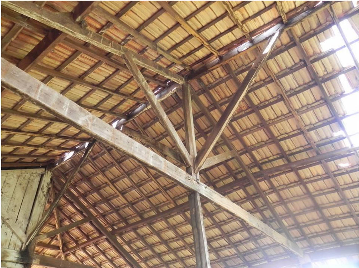
Figura 3 - Treliça com configuração espacial incorreta. Fonte: Carolina Sato Pereira
